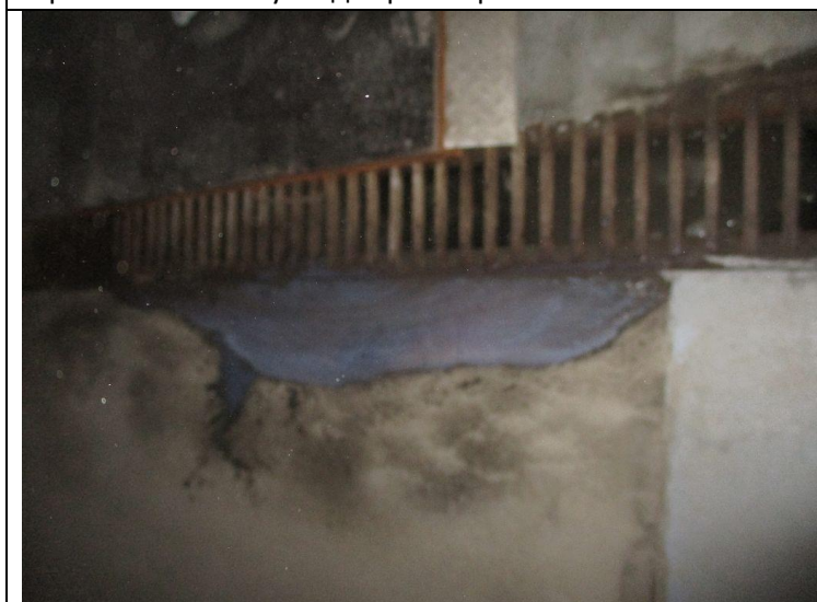
Кор.5, Сек.6-7 эт.1 Верхний уровень паркинга Ремонт покрытия пола -подготовка поверхности -приготовление и укладка раствора
